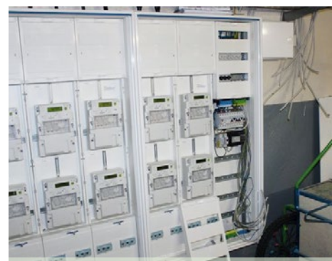
Neue elekt. Zähleranlage August-Rudloff-Str.
